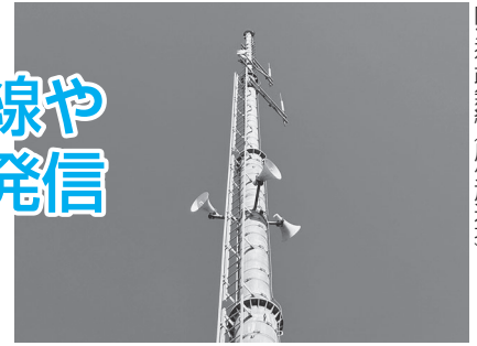
防災行政無線（屋外放送塔）
