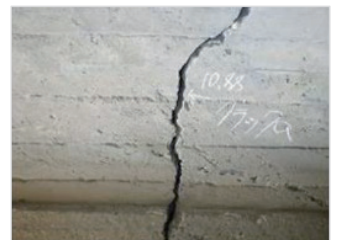
「緊急度Ⅰ」と判定した雨水管の亀裂
